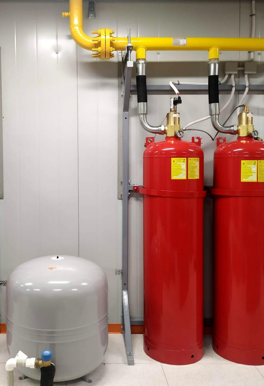
ЦОД «ПКК Миландр». Холодоцентр, модули газового пожаротушения
