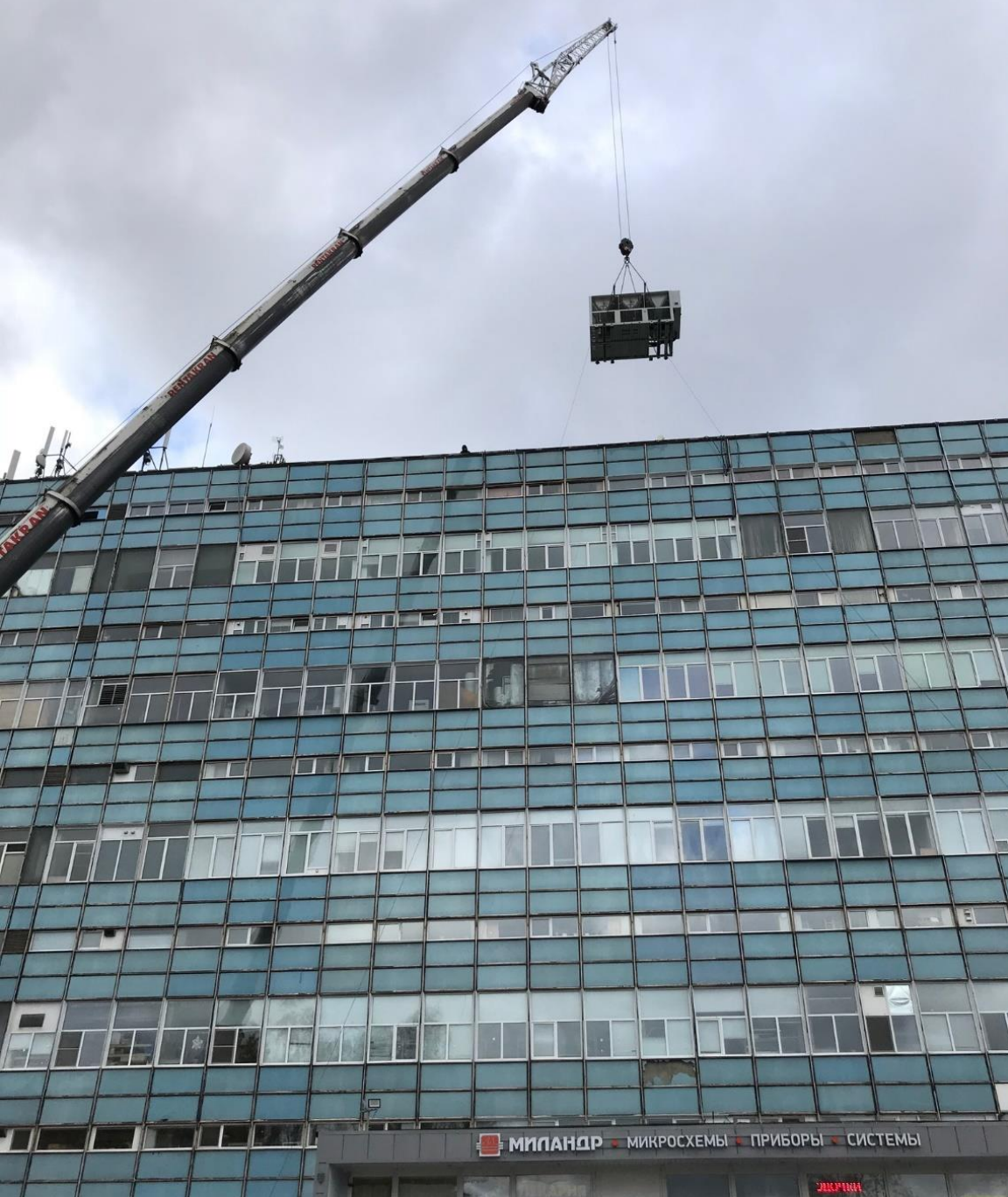
ЦОД «ПКК Миландр». Монтаж чиллеров
